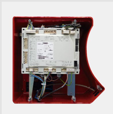
Feuerungsmanager W-FM100 oder W-FM200 im Brennergehäuse installiert
