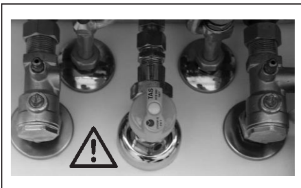
Bild: Gasanschluß: Gefahr von Vergiftung und Explosionsgefahr durch auströmendes Gas
