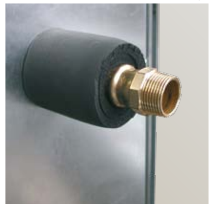
Wanddurchführung mit Armaflex-Isolierung
