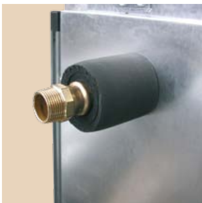
Wanddurchführung mit Armaflex-Isolierung
