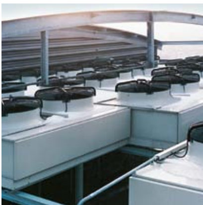
Kühlluftförderung durch Sichelventilatoren
