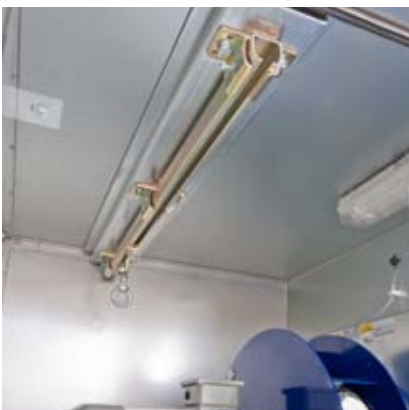
Auszugsschiene zum Ventilatortausch
