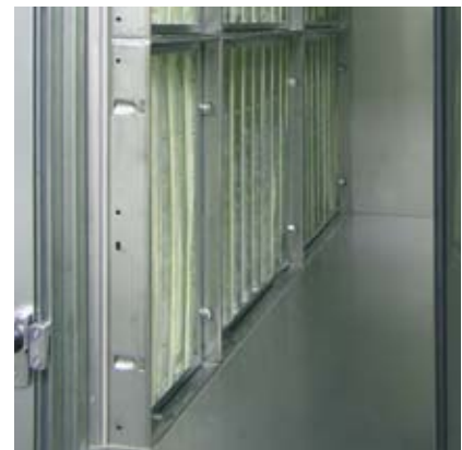
Filterrahmen fest eingebaut
