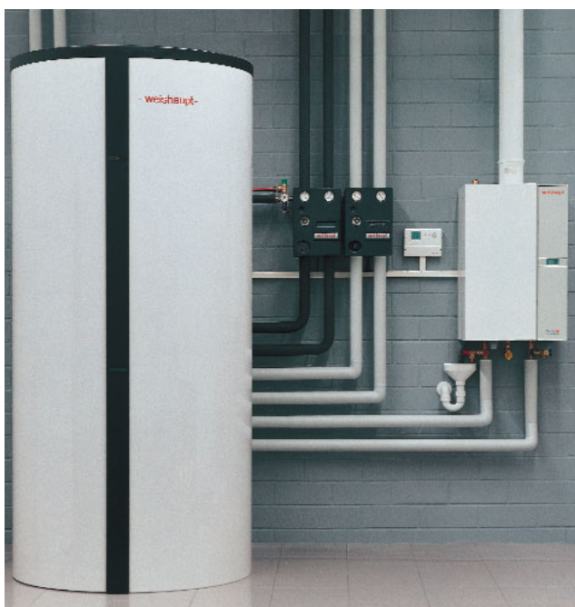
Weishaupt Energie-Speicher WES 910-C neben WTC
