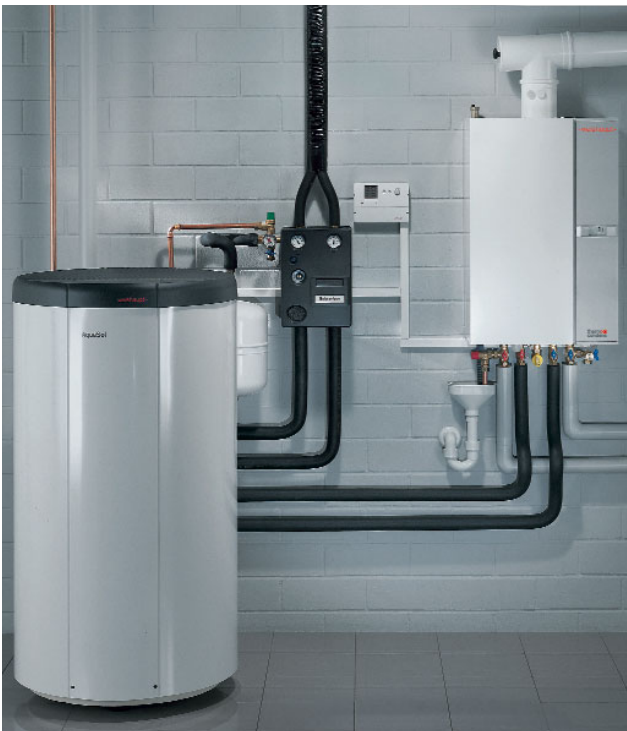
Bivalenter Trinkwassererwärmer WASol neben WTC
