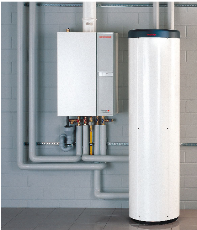
Trinkwassererwärmer WAT 140 neben WTC
